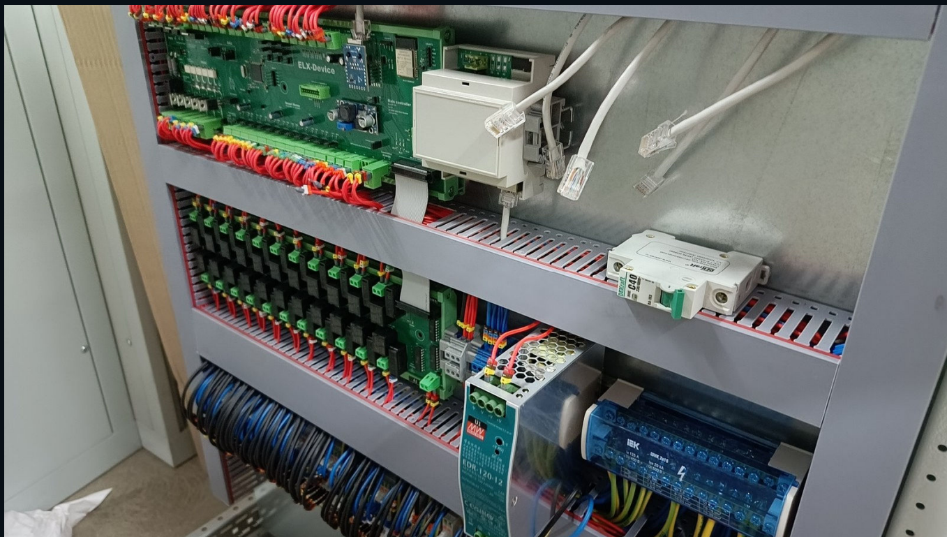
Смонтированный щит: плата управления сверху, плата реле ниже, блок питания и автоматы рядом
